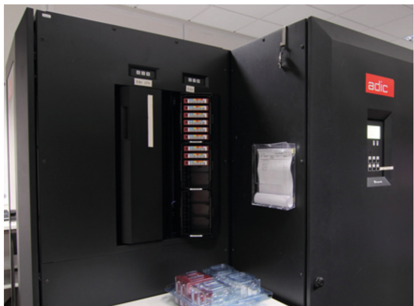
10 Bedienungselemente der ADIC/Quantum-S10000-Bandbibliothek im Maschinenraum der GWDG
